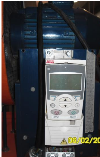
Figura 8.20. Variador de frecuencia de alimentación del motor eléctrico del ventilador. FI UNAM.
